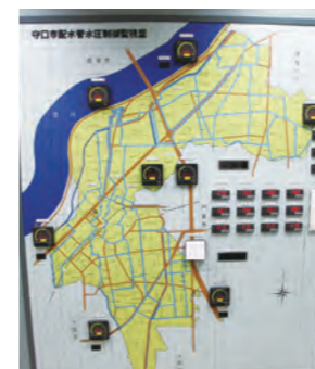
配水管水圧制御監視盤
