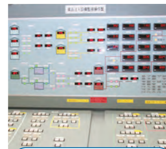
薬品注入設備監視操作盤
