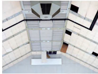
守口市民体育館天井の損傷(現在修理中)
