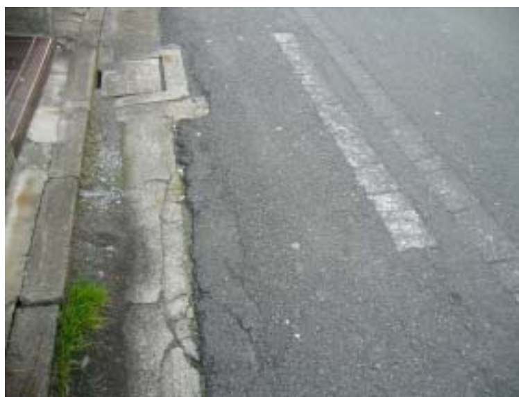
守口 56 号線のひび割れ状況
