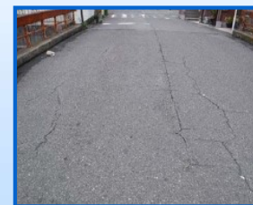
舗装ひびわれ
