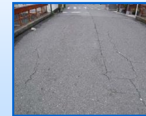
舗装ひびわれ
