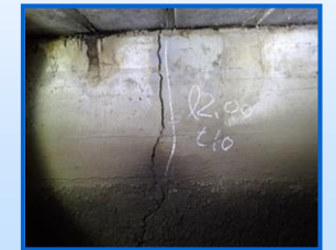
コンクリートひびわれ
