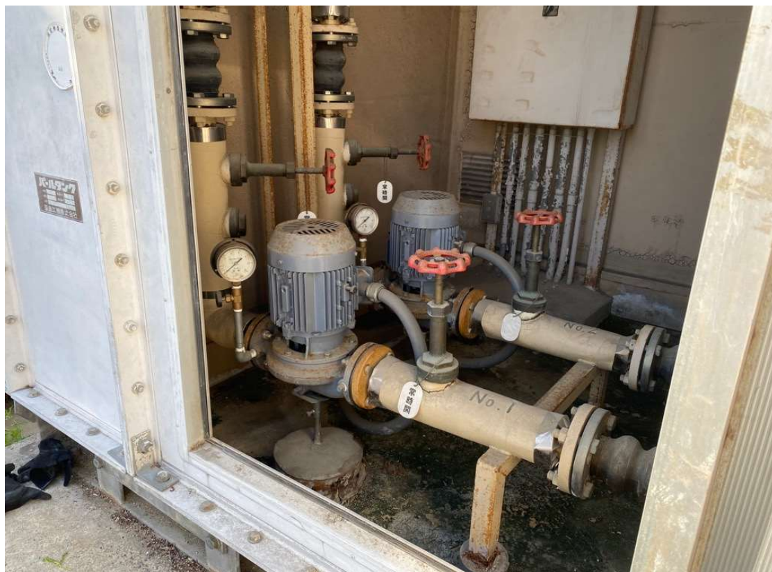
浄化槽写真(その2)
