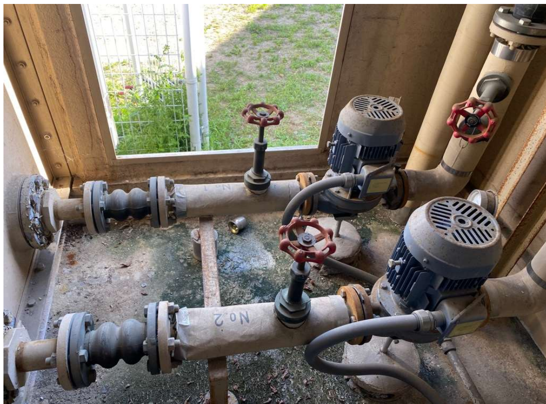
浄化槽写真(その6)
