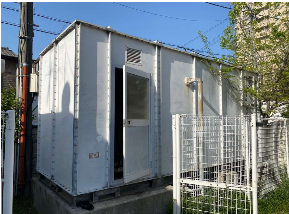
浄化槽写真(その1)
