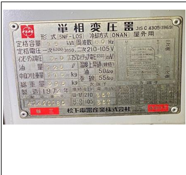
銘板（SNF-LOS 75KVA 1972年）
