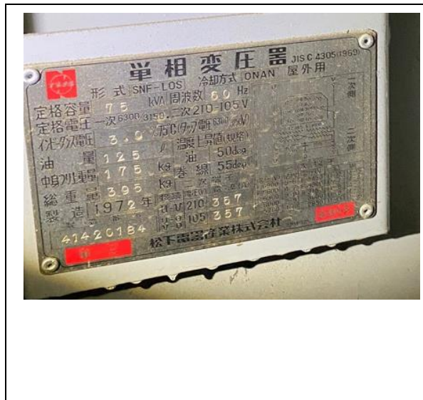
銘板（SNF-LOS 75KVA 1972年）
