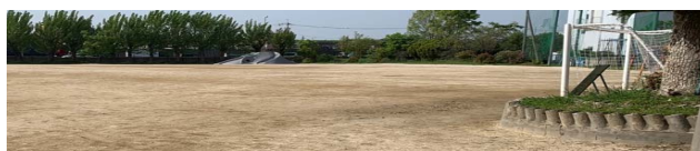
▲運動場の安全性と排水性を高めるため、整備工事を実施しました。
