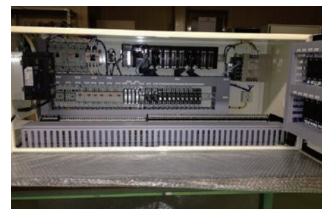
架台下制御盤
