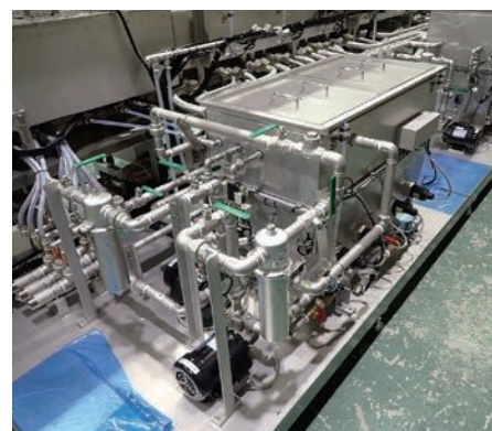
補機ユニット
