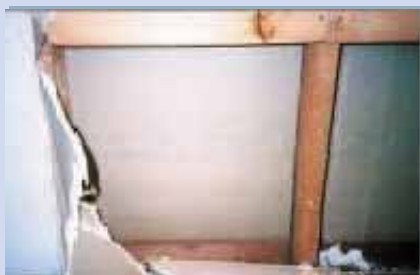
砒素・カドミ含有石膏ボード
