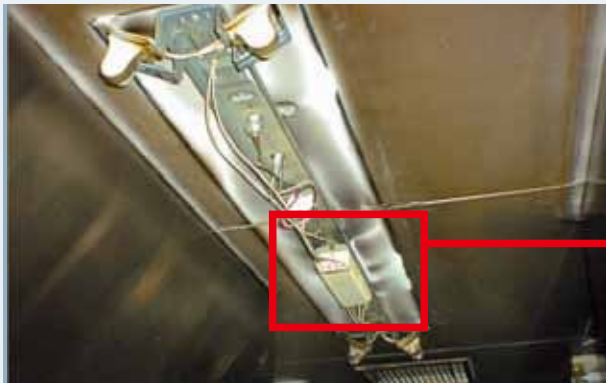
蛍光灯安定器
