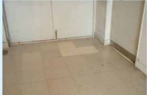
石綿含有ビニール床タイル（床）
