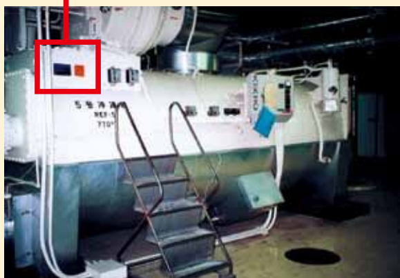
ターボ冷凍機
