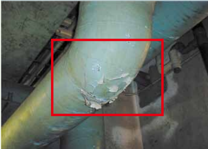
石綿含有保温材（配管曲がり部）
