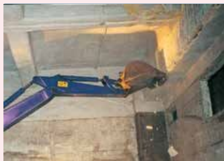
発泡ウレタン断熱材（吹付け）
