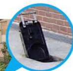
◀ マンホールトイレ
